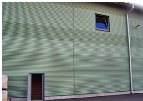
Eredeti, magasan beépített, hatástalan ablak
